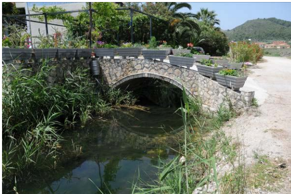
Εικόνα 10. Καλό παράδειγμα τεχνικού για την ανεμπόδιση κυκλοφορία των νερών στο περιμετρικό αποστραγγιστικό κανάλι (φωτογραφία: Κ. Ποϊραζίδης, 5/2013)
